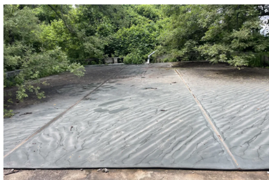
Réservoir d'eau actuellement utilisé pour le projet
